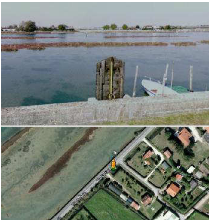
Figura 7-20: Esempio di chiavica manuale (sopralluogo AGRI.TE.CO aprile 2012)
