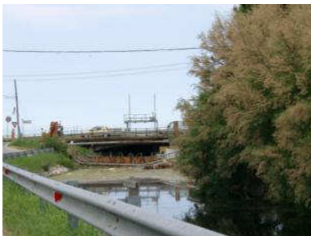
Figura 5-20: Lavori di sistemazione in prossimità della chiavica presso via Sette Casoni a Cà Ballarin (Magistrato alle Acque - AGRI.TE.CO, 2005)
