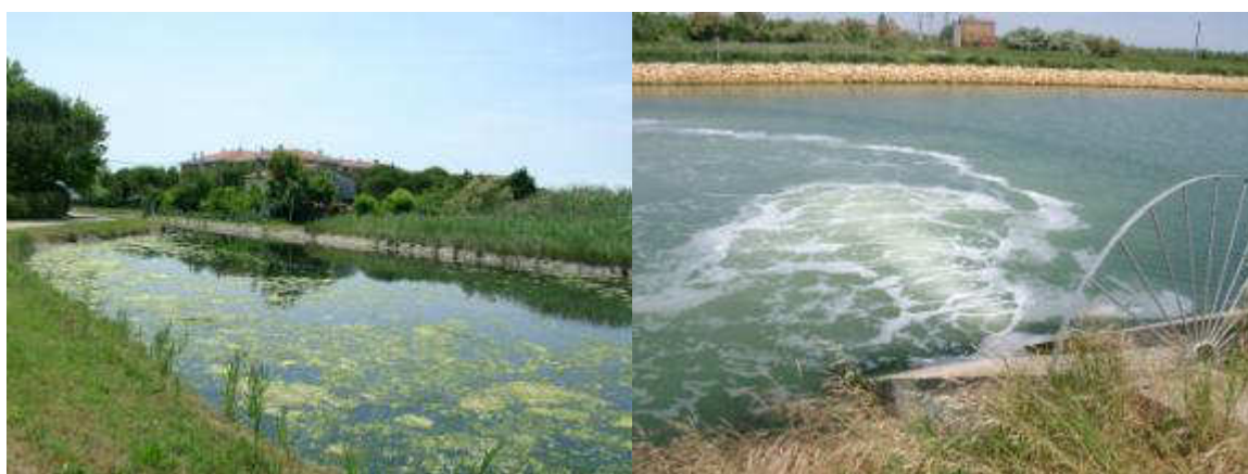
Figura 5-22: Il complesso con l'idrovora costituito dal manufatto in pietra, il bacino da cui si preleva l'acqua e le pompe che riversano l'acqua nel canale (Magistrato alle Acque - AGRI.TE.CO, 2005)
